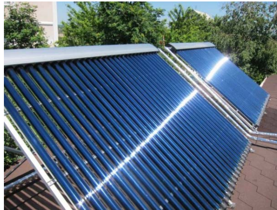
Рис. 11. Сонячний колектор на даху будівлі
