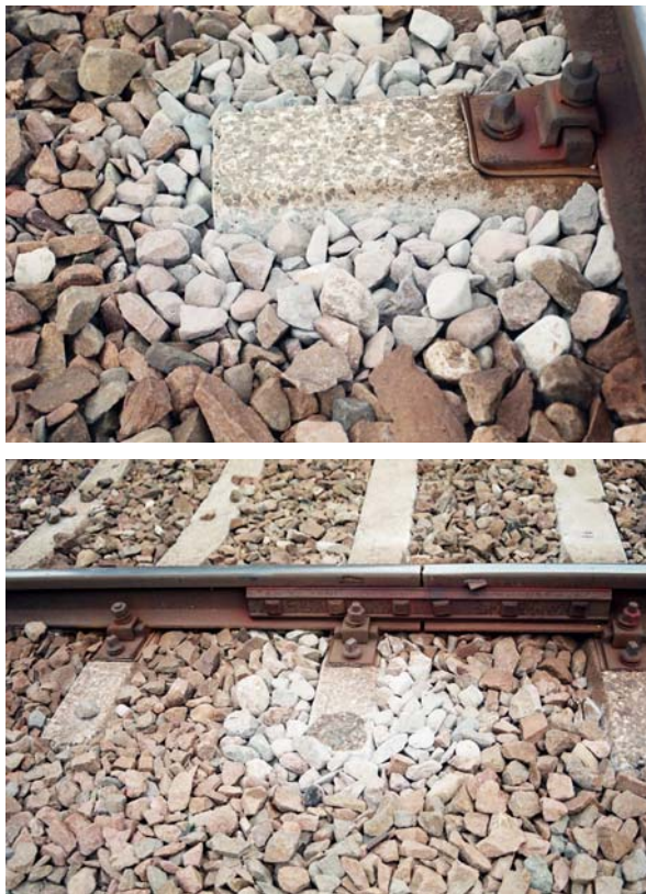
Рис. 6. Разбеливание цвета щебня в зоне некачественной подбивки шпалы
