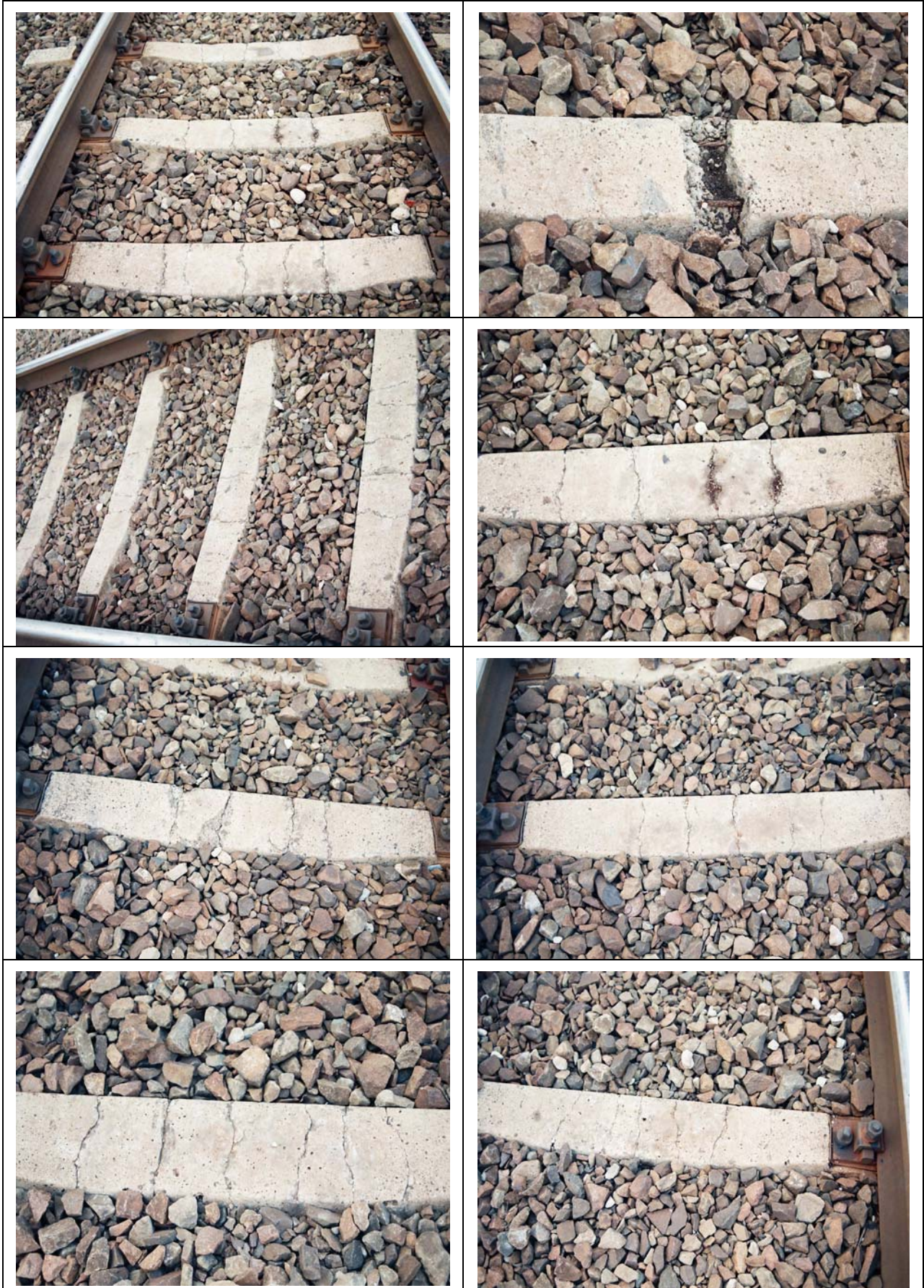
Рис. 5. Трещины и разрушения в средней части шпал INBK-7D
