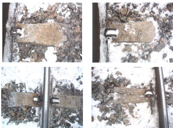
Рис. 2. Зруйновані шпали, що експлуатуються на Південно-західній залізниці
