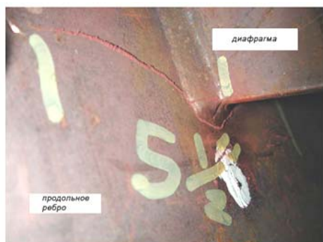
Рис. 14. Трещина усталости в узле пересечения ребер
