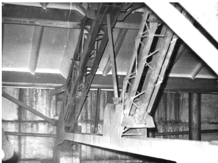
Рис. 12. Посилення стиснутих розкосів ферм покриття прольотом 36 м котельні Бурштинської ТЕС
