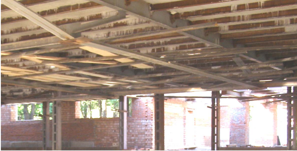
Рис. 5. Загальний вид балко-ферми перекриття в процесі будівництва L=18 м. м. Трускавець, санаторій «Женева», 2007 р.
