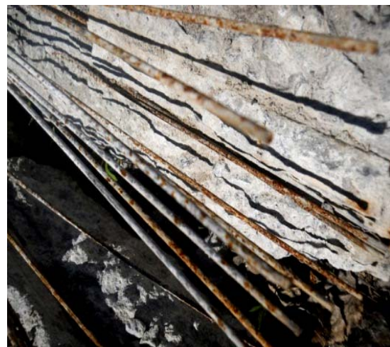
Рис. 2. Формування повздовжніх тріщин в розчинній частині макронеоднорідності бетону між арматурними прутами, які збіднені щебеневим заповнювачем
