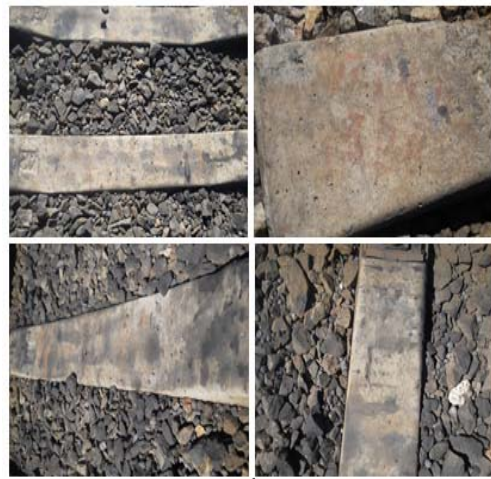
Рис. 12. Формування корозійних каверн в забрудненому бетоні шпал
