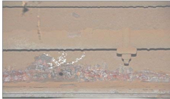
Рис. 1. Локальні корозійні пошкодження хребтової балки
