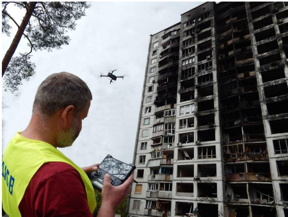
Рис. 1. Обстеження пошкоджених унаслідок воєнних дій будівель із використанням безпілотних літальних апаратів фахівцями ДП «Науково-дослідний інститут будівельного виробництва ім. В. С. Балицького» (м. Ірпінь, квітень 2022 р.)
