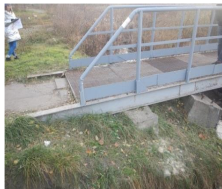
Рис. 8. Розмиття ґрунту підходів до мосту через відсутність організованого водовідведення та належного покриття
