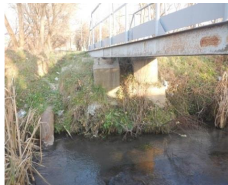
Рис. 7. Розмив та зсув фундаментних блоків через підвищення рівня річкової води
