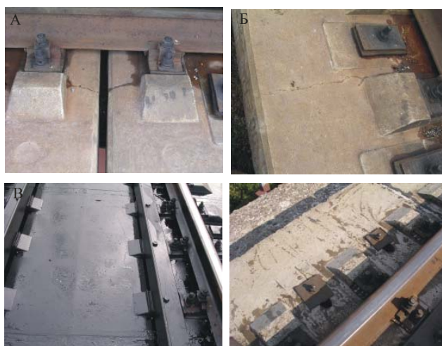
Рис. 4. Характерные нарушения эксплуатации плит безбалластного мостового полотна: а) продольные трещины по подрельсовой площадке; б) поперечные трещины около подрельсовых площадок; в) продольные трещины в зоне крепления контруголков; г) открытые шпилечные отверстия
