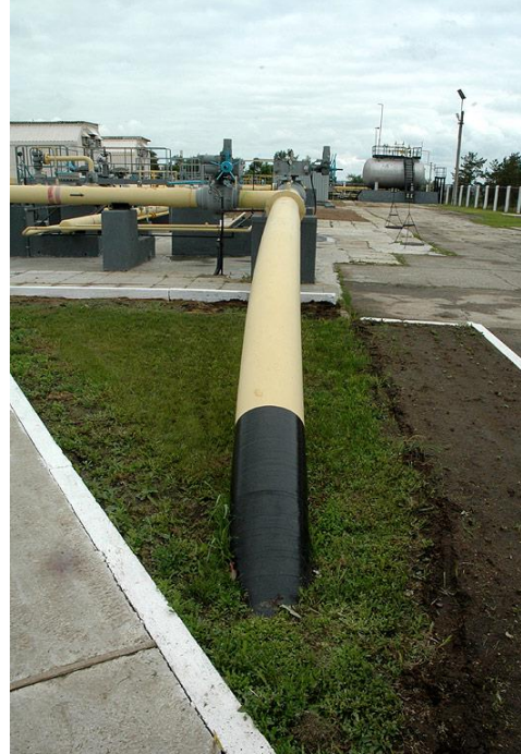
Рис. 5. Трубопроводи на території насосної станції для перекачування аміаку ( https://ru.wikipedia.org/wiki/Аммиакопровод )
