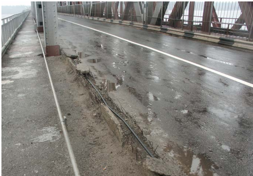
Рис. 3. Хлоридна корозія бетонного бордюру
