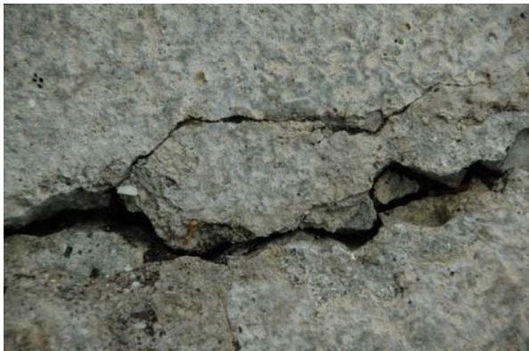
Рис. 4. Руйнування бетону під впливом сульфатної корозії
