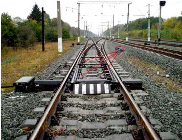
Рис. 4. Место установки роликовых узлов на стрелочном переводе проекта Дн300.00.000, уложенного на ст. Халимоново
