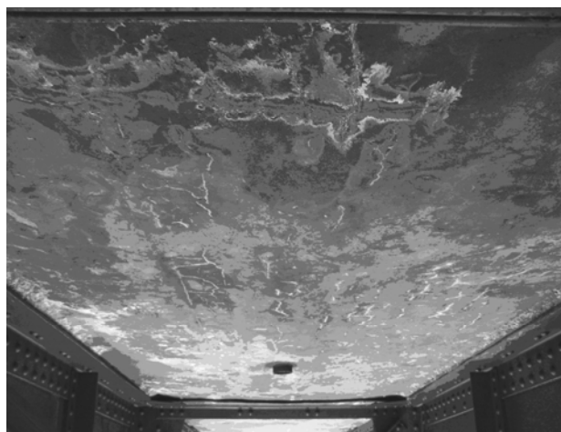
Порушення гідроізоляції (вилугування)
