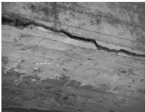
Тріщина розкриттям більше 10 мм (від удару)
