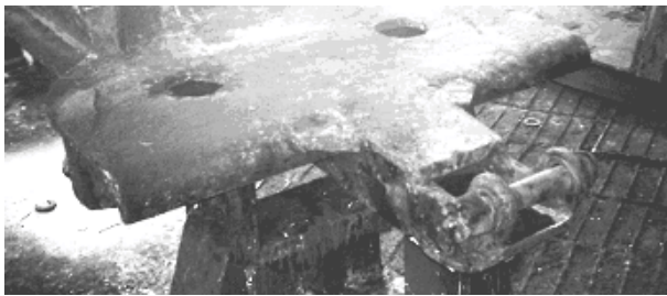
Рис. 1. Коррозионный износ консольной части надрессорной балки тележки электропоезда ЭР1 зав. № 033 (январь 2005 г.)
