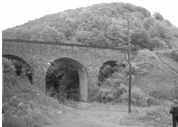
Рис. 10. Вид моста, расположенного в кривой радиуса 185 м. участка Львовской железной дороги на направлении Тернополь –Чертково
