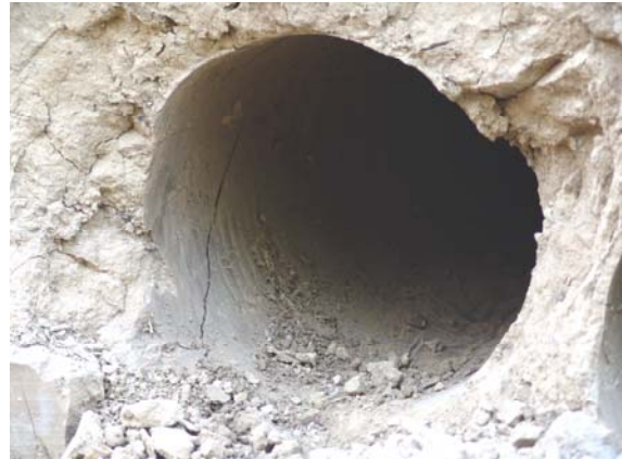
Рис. 6. Характер деформирования контура скважины после ее бурения
