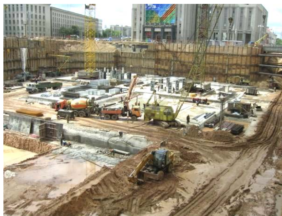
Рис. 7. Общий вид котлована на пл. Независимости в г. Минске с заанкеренными ограждающими стенами при возведении в нем конструкций общественно-торгового центра с парковкой
