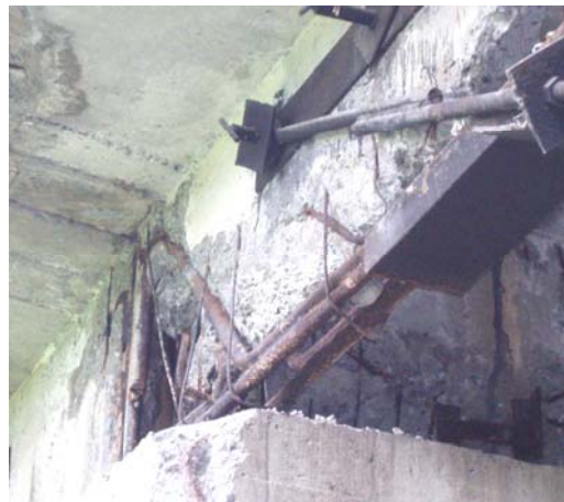
Рис. 1. Характерні дефекти прогонової будови мосту на автомобільній дорозі Житомир – Чернівці, км 216+920:
