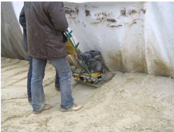
Рис. 1. Пошарове ущільнення ґрунту засипки при влаштуванні металевої гофрованої труби: а – за допомогою спеціальної техніки; б – із застосуванням ручних трамбувальних механізмів
