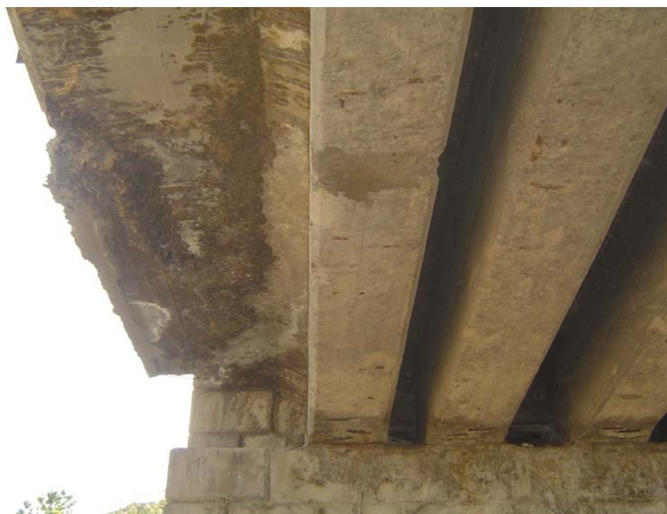
Рис. 1. Железобетонный мост через р. Чартаксай. Выщелачивание бетона и коррозия арматуры в плите проезжей части
