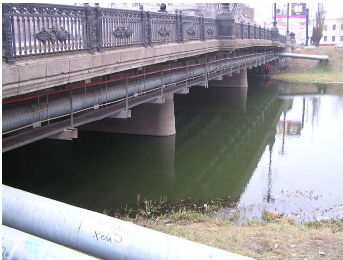
Рис. 1. Размещение труб теплотрассы под тротуаром
